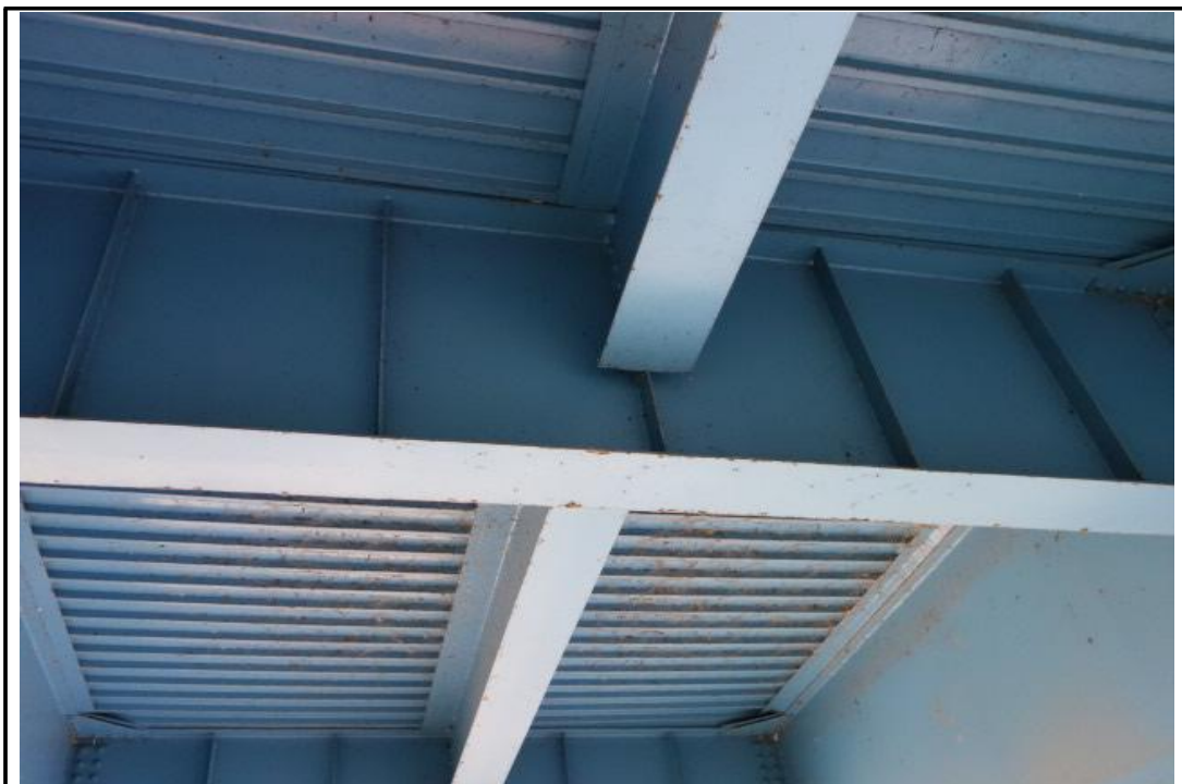
STB 거더 구간 세로보 전경
